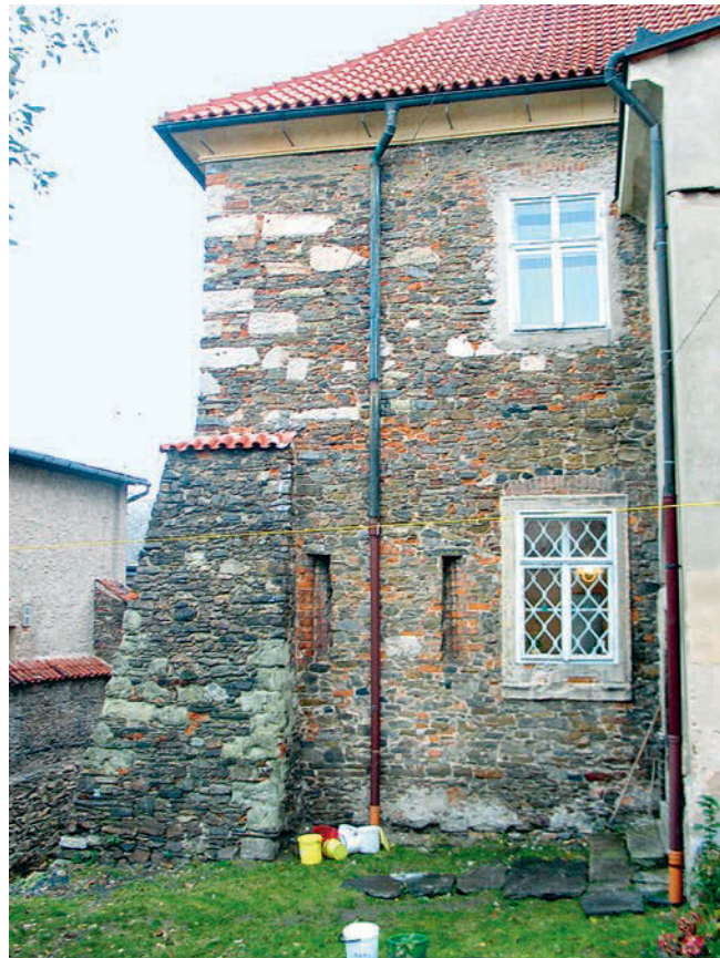
Obr. 20: Kolín, arciděkanství (Brandlova čp. 25), západní fasáda severovýchodního křídla, v přízemí s fragmenty stojek ostění druhotně zazděného gotického okna, stav 2004.
