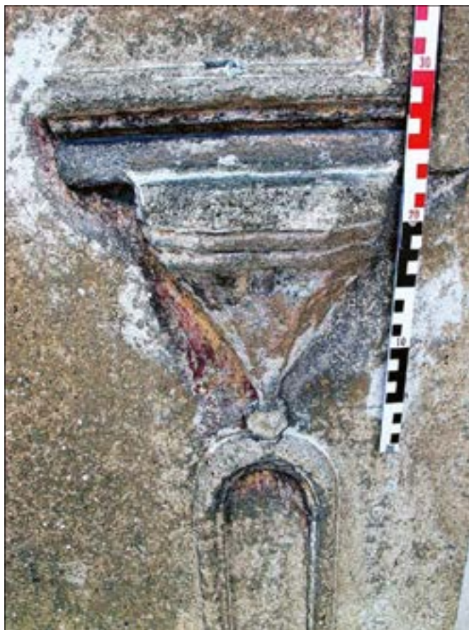
Dobrovíz (správní obvod obce Černošice), dům usedlosti čp. 4. Průzkum fasády. Detail šambrány oken patra se zřetelnými vrstvami barevnosti (foto M. Hanzlíková).
