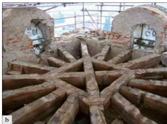
Družec, (správní obvod obce Kladno), farní kostel Nanebevzetí Panny Marie: a – rozebírání konstrukce střešní bání s lucernou zastřešující západní věž, stavebně technický stav byl havarijní; b – základový rošt tesařské vazby věže po snesení vrchní části (foto E. Volfová).
