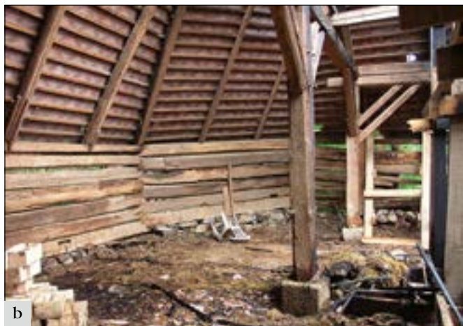
Ohrobec (okres Praha-západ), areál usedlosti čp. 12, polygonální stodola, stav těsně po požáru: a – pohled na ohořelé trámy polygonu západní perny; b – požárem nezasažená štenýřová konstrukce a roubení polygonu východní perny (foto M. Hanzlíková, srov. s. 18).
