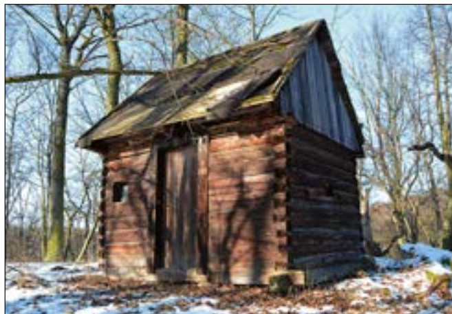
Hřebečnický (okres Rakovník), sroubek na tzv. Písařově vrchu v lesích nad Berounkou je zřejmě posledním z autenticky zachovaných obdobných staveb. Jeho prohlášení kulturní památkou se podařilo v roce 1998, tehdy také bylo provedeno základní zajištění střechy. Od té doby je drobná a skutečně unikátní památka ponechána v podstatě bez zájmu, pokud nebude okamžitě provedena po téměř dvaceti letech další malá a laciná oprava, hrozí jí skutečný zánik (foto J. Mrázek).
