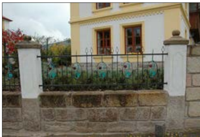
Skalsko (okres Mladá Boleslav), čp. 19. Oplocení u tohoto výstavního domu se štítovou bránou z roku 1833 bylo na počátku 20. století doplněno originálním kovovým plotem zdobeným růžemi. Jeho repase s doplněním zaniklých a dožilých částí, včetně opravy kamenné podezdívky, završila celkovou obnovu usedlosti a zachránila tento vzácný doklad dobového uměleckého řemesla do budoucnosti (foto J. Berková).
