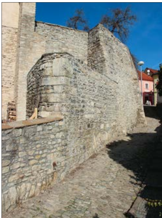
Kutná Hora (okres Kutná Hora), zeď pod Hrádkem. Havarijní stav vysoké stěny v úzké uličce Pod Hrádkem byl sanován dvěma způsoby: helifixální výztuží a přezděním nejvíce problematických partií. Prováděcí firma se zkušeností například z opravy terasních zdí nedalekého parku Pod Vlašským dvorem práce provedla bez znatelných předělů starých a nových úseků. Po stržení hustého zeleného porostu, který zeď z větší části dlouhodobě pokrýval, se objevil pozůstatek středověké Podhrádecké brány (foto A. Pospíšil).
