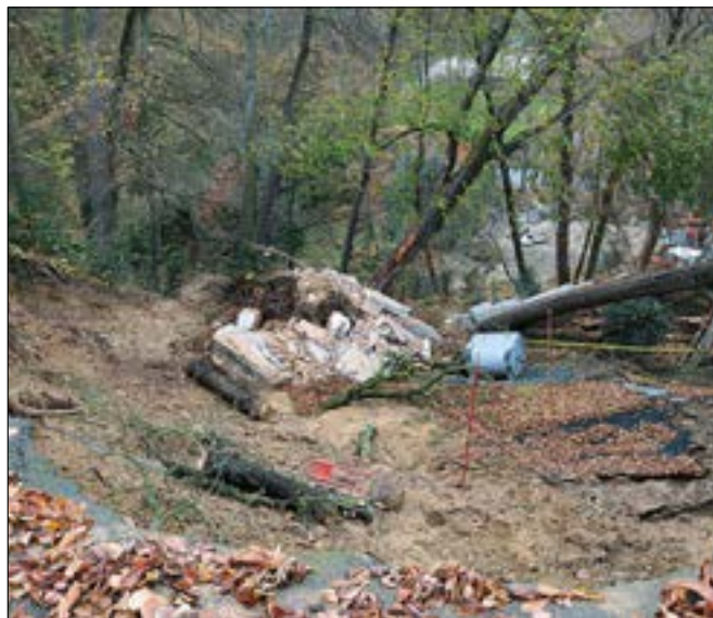
Vlašim (okres Benešov). V zámeckém parku ve Vlašimi se na začátku října 2016 sesunula část svahu, která byla tvořena nestabilní navázkou. Stav bezprostředně po sesuvu. Otázka způsobu sanace bude řešena v příštím roce (foto A. Rudl).
