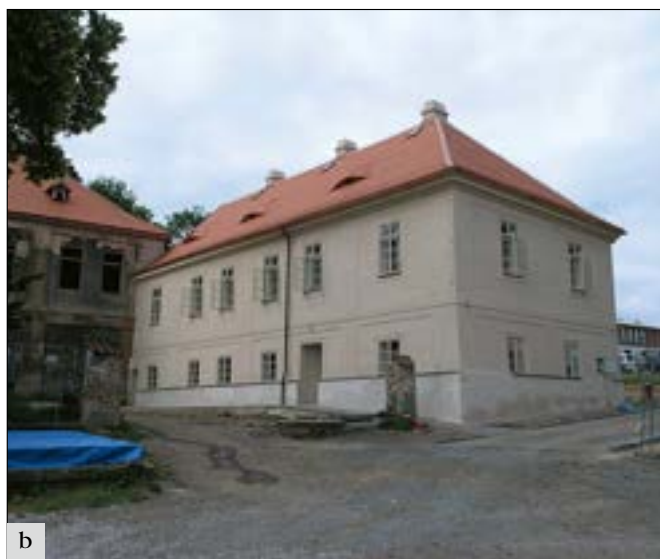
Koleč (okres Kladno): a – západní zámecké křídlo těsně před opravou v roce 2014, v pohledu z opraveného krovu nad kostelní lodí; b – západní křídlo se díky získání finančních prostředků z Norských fondů podařilo doslova „na poslední chvíli“ zachránit. V současnosti je v něm umístěno muzeum včelařství a je přístupné veřejnosti (foto E. Volfová).
