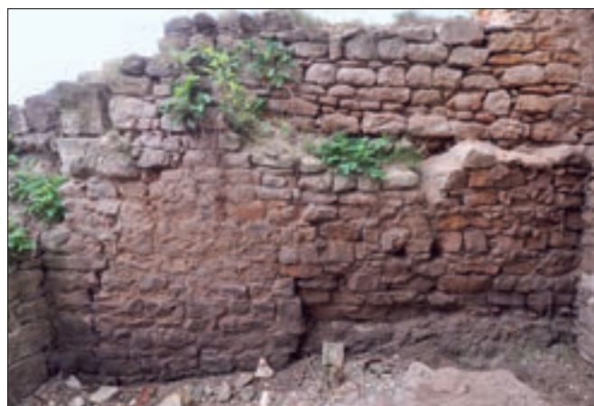
Vyšehořovice (okres Praha-východ), zřícenina tvrze. Boční stěna interiéru prostoru pod průjezdem brány tvrze představuje složitou nálezovou situaci, na jejíž dokumentaci a vyhodnocení se musí společně podílet stavební historik a archeolog. Při průzkumech historické architektury je tento požadavek velmi častý, málokterá nálezová situace pochází z jediné vývojové fáze. Základem dokumentace je v takovémto případě fotogrammetrické zaměření (foto V. Razím, 2014).
