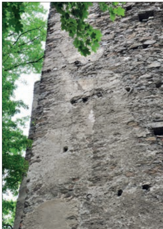
Zruč nad Sázavou (okres Kutná Hora), tzv. Kolovertsá věž opevnění zámku. Na vnějším plášti věže se dochovaly rozsáhlé zbytky omítek, včetně otisku strmé pultové stříšky krytého ochozu bradební kurtiny. Přesné zaměření a podrobná dokumentace z lešení musí být v takovém případě samozřejmostí (foto V. Razím, 2014).
