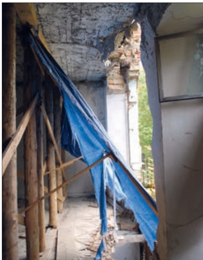
Pravonín (okres Benešov), dnes opět soukromý zámek, který byl ještě v nedávné době využíván, je nyní již ve stavu, kdy původní historické konstrukce a detaily stavby, jejíž nejstarší dochované části pocházejí ze 16. století, se rozpadají a nevratně zanikají (foto J. Mrázek).
