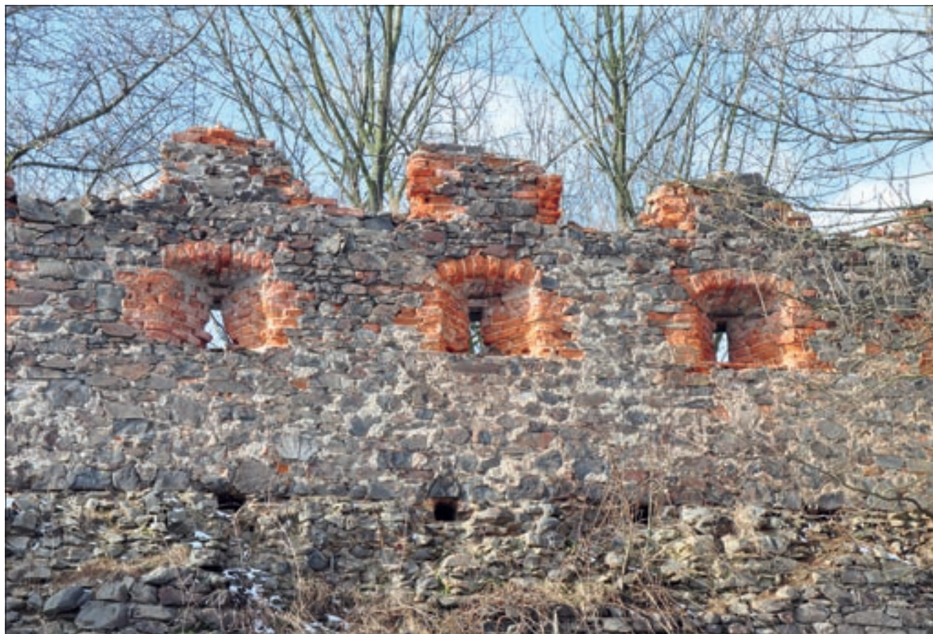
Předbradí (okres Chrudim), opevnění městečka. Technický stav některých nemovitých památek je natolik neutěšený, že rychle ubývá jejich vypovídací hodnota. U dochované části opevnění Předbradí je to způsobeno mimo jiné pokračující korozí cibelných částí, které jsou v tomto případě nejceněnějšími detaily. Kromě stržených je zejména o přezovou krytinu pultových stříšek horních zubů. Současné záchranné dokumentace je podrobné geodetické zaměření a fotodokumentace s využitím žebříku (foto V. Razím, 2014).
