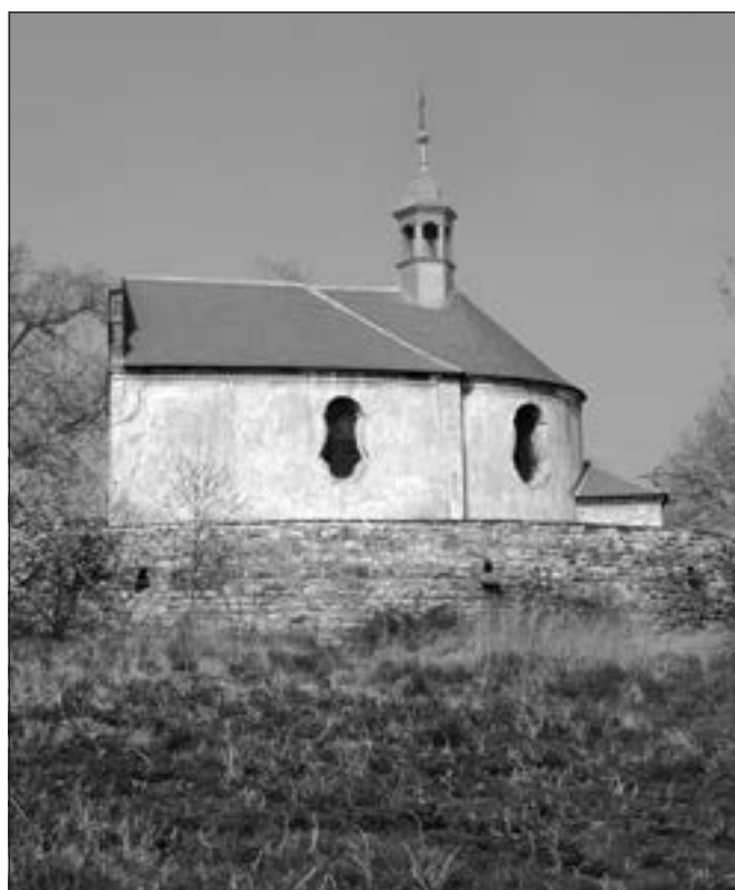
Podolánka, část Cvrčovice (okres Praha-východ), kostel Stětí sv. Jana Křtitele. Za velmi významné je nutno považovat dokončení obnovy střešního pláště a krovu kostela. Bylo tím dovršeno dlouholeté úsilí představitelů obce, památkových orgánů a dalších osob o záchranu této významné zdevastované a opuštěné kulturní památky. V rámci etapy, realizované v roce 2013, byla provedena kompletní rekonstrukce sanktusníku (foto J. Žížka).
