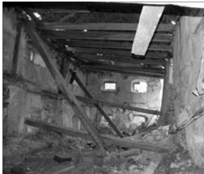
Beřovice, část Bakov (okres Kladno), budova bývalé renesanční tvrze, později přestavěná na barokní sýpku, ne zcela neobvyklý příklad zanikající cenné stavby, kdy neexistuje možnost, jak účinně její zkáze zabránit; v tomto případě skutečný zánik nastal po vandalském poškození, kdy byla vyřezána část svazujících trámů a ukradeny železné kleštiny, obratem nastalo zřícení celého nároží stavby a další praskání a ujiždění masivních kamenných zdí pokračuje (foto J. Mrázek).
