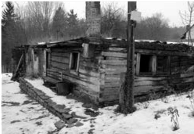
Chedrbí (okres Kutná Hora) dům čp. 121. Stav roubeného stavení, jebož krov byl zničen před několika lety požárem, se v důsledku nedostatečného zastřešení stále zboršuje (foto J. Berková).
