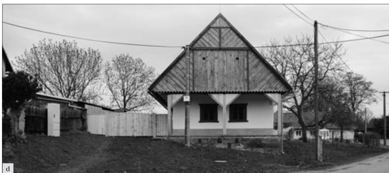
Žitovlice (okres Nymburk), usedlost čp. 24. Mimořádně hodnotná roubená usedlost byla v bavijském stavu a určena k demolici. Díky porozumění nového vlastníka byla prohlášena za kulturní památku a následovala poměrně rychlá celková obnova. Stav roubených konstrukcí si vyžádal poměrně velké výměny prvků a odstranění podstatné části původních bliněných omítek, které však byly následně ve velmi dobré kvalitě zpětně obnoveny. Součástí akce byla také obnova štítu, vycházející v základním členění z dochované dobové fotografie, v detailech ozdobných prvků pak z analogií dochovaných na stavbách v sousedních vesnicích: a, b – stav před obnovou (foto V. Láška, 2009); c, d – stav po obnově (foto J. Berková).
