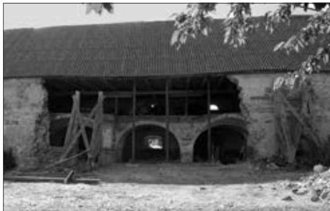
Stránka (okres Mělník), sýpka v hospodářském dvoře zámku čp. 1. Ani mohutné dřevěné vzpěry nezabránily zřícení části severozápadní obvodové zdi sýpky. Odhalil se tak efektní pohled do útrob stavby, umožňující detailní zkoumání struktury zdiva, kleneb i dřevěných konstrukcí (foto J. Veselý, srpen 2013).
