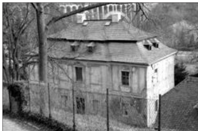
Krnsko (okres Mladá Boleslav), fara. Pozdně barokní budova fary v Krnsku byla až do nynější opravy v kritickém stavu s vážnými statickými poruchami. Po provedení základního zajištění zabýval majitel opravu krovu s výměnou krytiny, která byla v tomto roce dokončena. Vikýře byly obnoveny jako věrné kopie původních s využitím části původních prvků. Obnova dřevěného šindele podle původního stavu není u objektů tohoto druhu běžná. Oprava střechy fary v Krnsku patří k realizacím provedeným po řemeslné stránce kvalitně s respektováním původních konstrukcí, detailů a materiálů a lze ji z památkového hlediska hodnotit velmi kladně (foto E. Vyletová).
