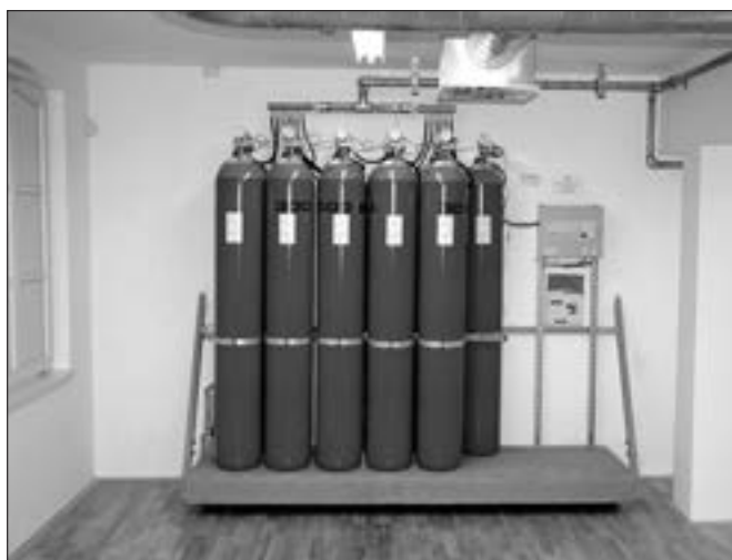
Kutná Hora – Hlouška, centrální depozitář, labve s inertním plynem a ústředna stabilního zhašecího systému (foto archiv NPÚ).
