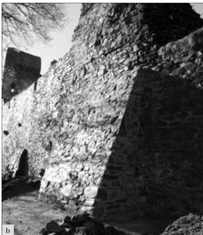
Krakovec (okres Rakovník), hrad: a – baviče východní strany obvodového zdiva; b – stejné místo již opravené.
