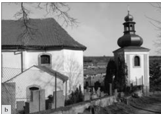
Slatina (okres Kladno), zděná zvonice u kostela sv. Vojtěcha: a – nakloněná střecha věže s mohutnou cibulovou bání bezprostředně brozila zřícením; b – během dvou let se podařilo opravit vážně poškozenou vazbu krovu, doplnit bednění a provést nové oplechování pláště věžní bání s lucernou, včetně výměny brotníce s pozlacením nového kříže ve vrcholu (foto E. Volfová).
