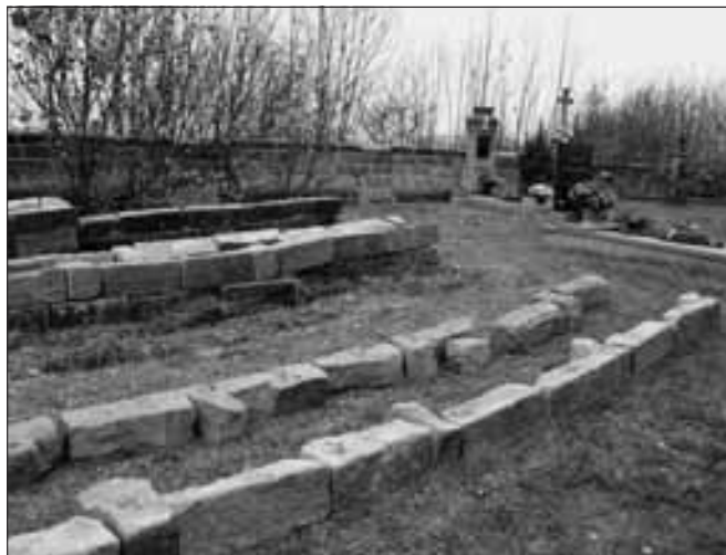
Chotěšice (okres Nymburk), kostel Rozeslání sv. Apoštolů. Zeď vymezující areál hřbitova kolem kostela a zároveň sloužící jako opěrná zídka se nachází v bavarijním stavu a na několika místech brozí zřícením. Její oprava probíhá po úsecích, volených dle míry poškození. Na snímku je patrný postup rozebrání a označení jednotlivých dílců zdi v průběhu stavby v rámci etapy v roce 2011, která byla zaměřena na zajištění úseku po západní straně vstupní branky (foto M. Zemková).
