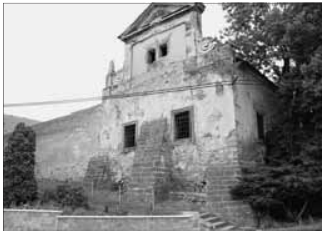
Černuc (okres Kladno), obytná budova raně barokního dvora. Mimořádně hodnotná stavba se po dlouhém chátrání dostala do stavu krajního obrození. Díky pochopení vlastníka a také snahou všech zúčastněných se podařilo připravit podmínky pro postupnou opravu, která byla zabývána prací na statickém zajištění (foto J. Mrázek).
