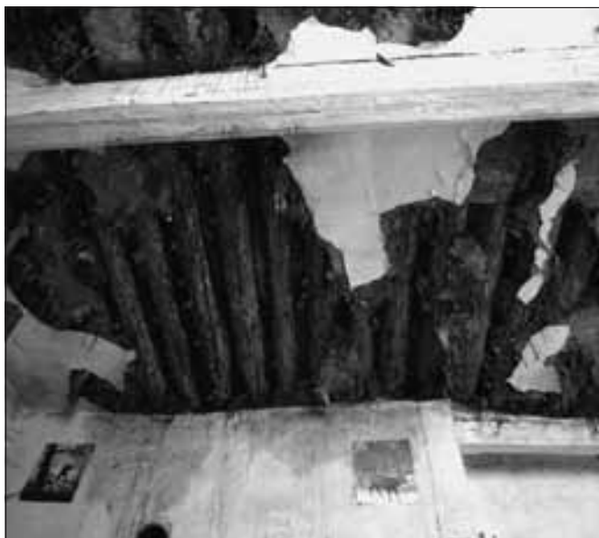
Hořovice (okres Beroun), fara čp. 33. K odhalení obzvlášť hodnotných nebo významných prvků dochází u chátrajících staveb často až při jejich destrukci. Na snímku je patrný archaický, původně pobledový povalový strop v jižní obytné místnosti farní budovy. Povaly, datované dendrochronologicky do 40. let 17. století, se objevily až vlivem zatékání po demolici zbytků požárem poškozené střechy (foto J. Veselý, 2011).
