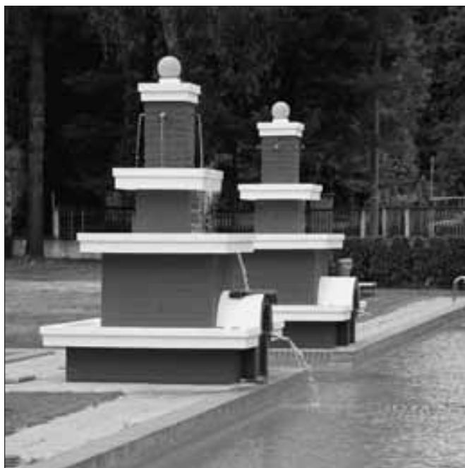
Mšeno (okres Mělník), areál městských lázní z 30. let 20. století. Obě fontány akcentující hlavní vstup do bazénu byly dlouhá desetiletí mimo provoz. Nefunkční rozvody, popraskané betonové vany jednotlivých kaskád a rozpad části cihelného zdiva si vyžádaly zásadní obnovu, při níž byla část nosné konstrukce přezděna a nově provedena většina železobetonových van. Byly obnoveny a doplněny rovněž mosazné chrliče vody a na vrchol fontán vráceny chybějící kamenné koule podle dobové fotodokumentace (foto J. Berková).
