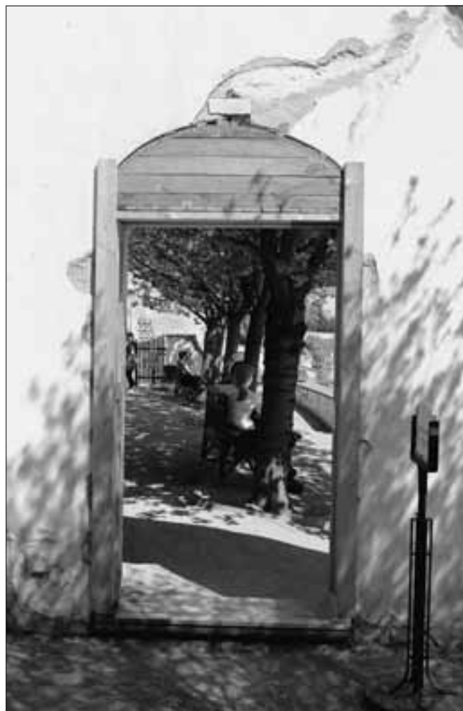
Zabrády pod Pražským hradem, provizorní podpěra klenby průchodu mezi zabradami pro zajištění bezpečnosti návštěvního provozu (foto V. Láská).
