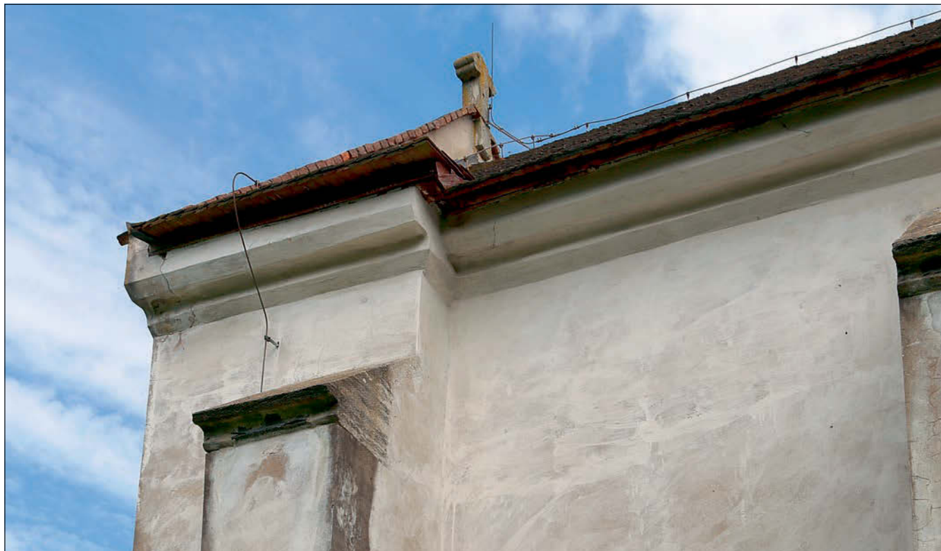
Obr. 18: Markovice, kostel sv. Marka, detail korunní římsy při jihozápadním nároží kostela, stav 2023.
