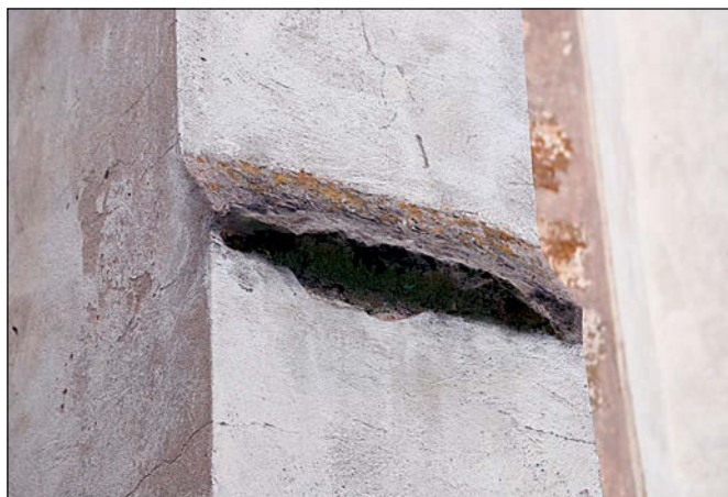
Obr. 8: Markovice, kostel sv. Marka, detail odtesáním poškozené původní kamenné gotické římsy odstupnění opěráku na východojihoovýchodním nároží presbytáře, stav 2023.
