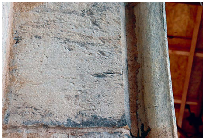
Obr. 5: Beroun, Pražská brána, vnější arkáda západního portálu, zřetelné přetnutí značky ve tvaru špic-plošiny hruškovcovým profilem, detail, stav 2023.
